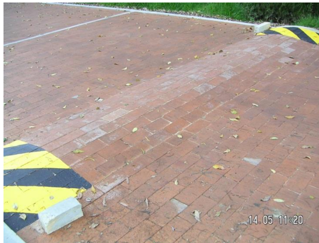
Fig. 3. Resalto físico construido por el IDU en Bogotá.
