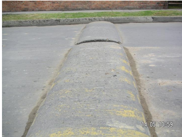
Fig. 4. Resalto físico construido por el IDU en Bogotá.
